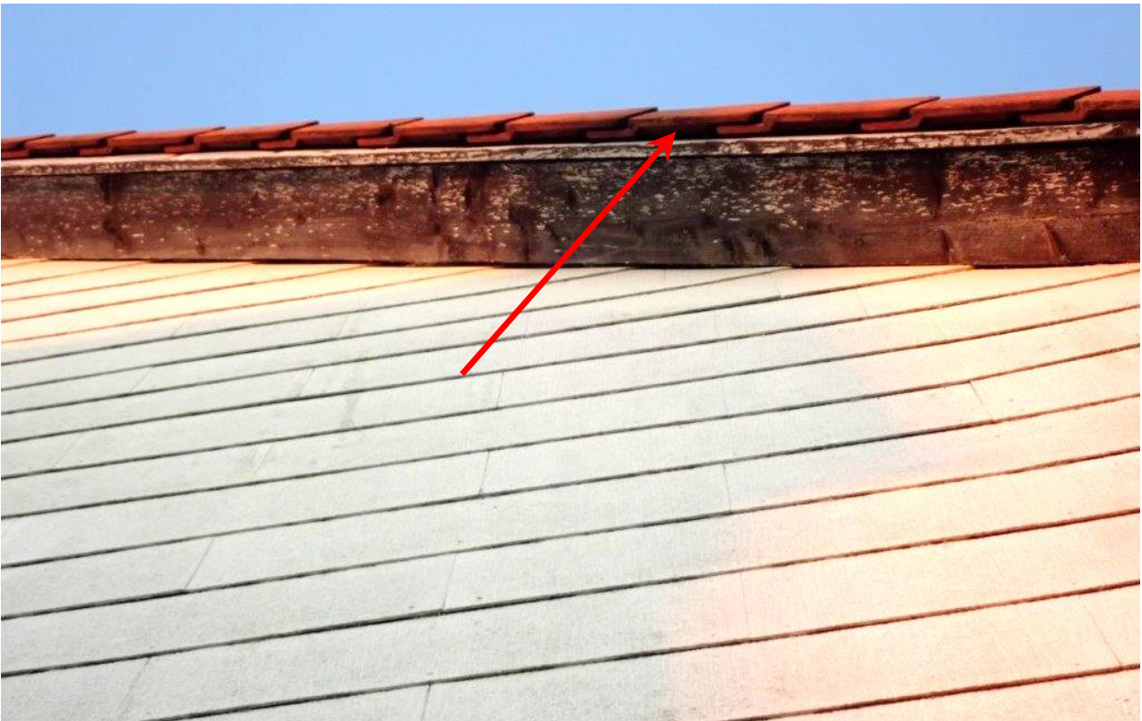
Abbildung 5: Ortgang an einem der südlichen Häuser. Die Randziegel bilden mit den unter ihnen liegenden Brettern kleine Nischen (Pfeil), die mitunter von Zwergfledermäusen und anderen kleinen Arten aufgesucht werden können (Foto: Moos, Juni 2022).
