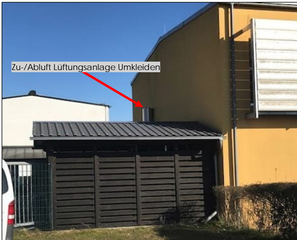
Abbildung 4: Lüftungsanlage an der Nordfassade der Turnhalle /4/
